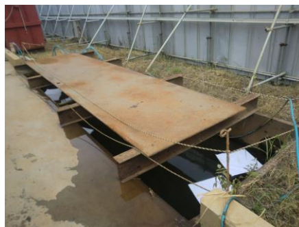
(当社設置のオイルピット)
